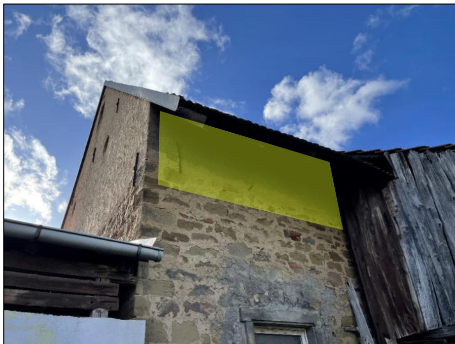
Foto 12: Geplantes Spaltenquar- tier an der nordostexpo- nierten Außenfassade (gelb)
