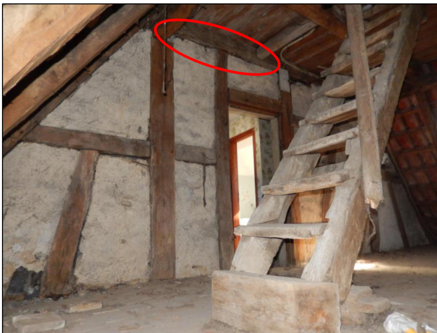
Foto 12: Zwischen Holzbalken und Gipswand befinden sich zahlreiche Spalte, die als Fledermausquar- tiere fungieren können.
