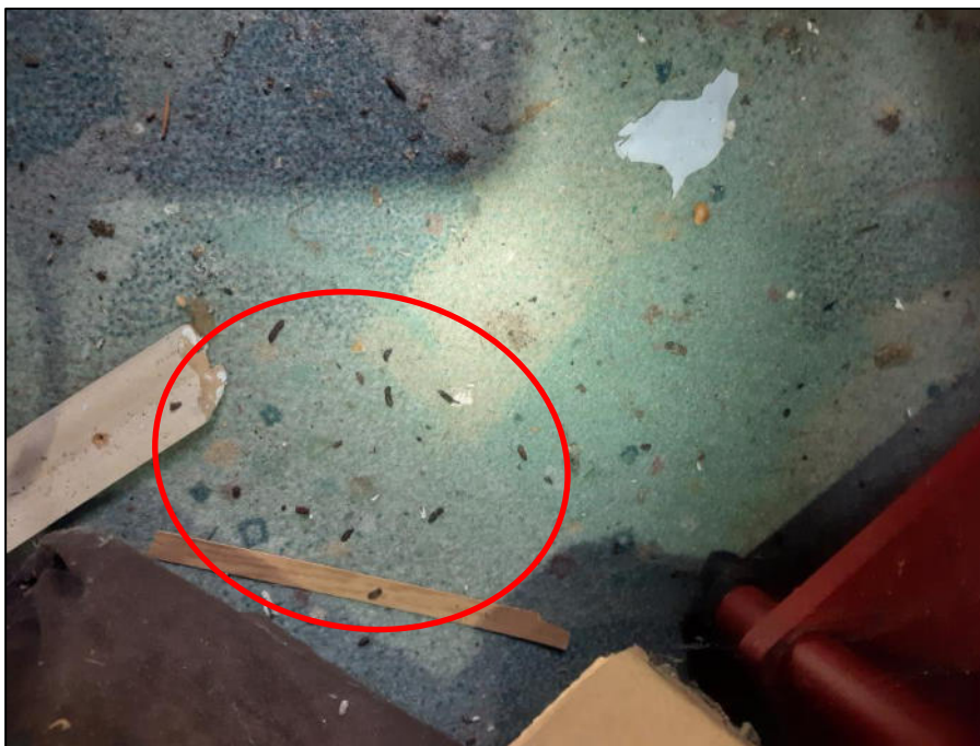
Foto 10: ... als auch durch Fledermäuse in Form von Nistmaterial und Kot festgestellt werden.
