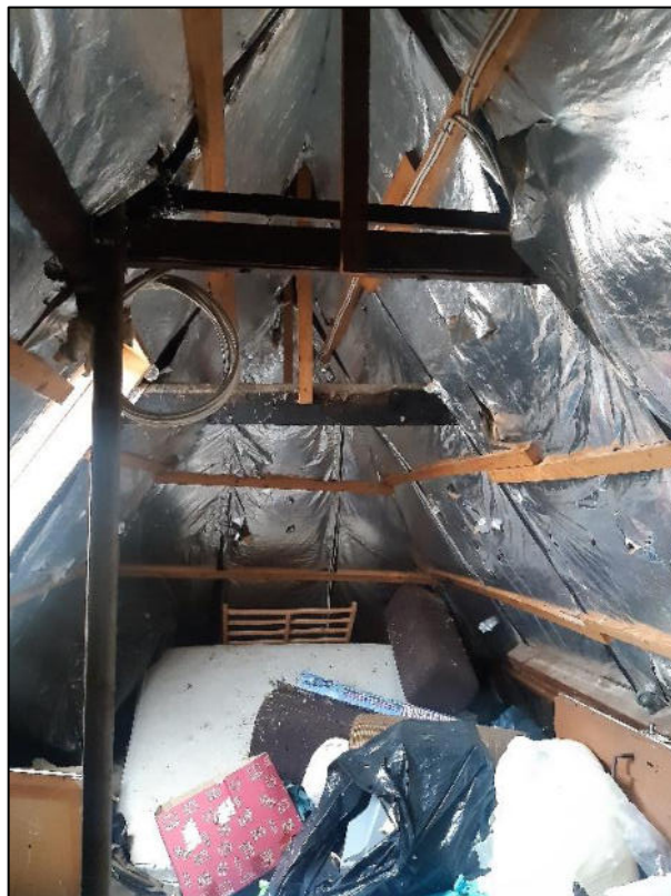
Foto 1: Das gesamte Dämmmaterial im Haus Nr. 17 ist unter ökologischer Baubegleitung zu entfernen
