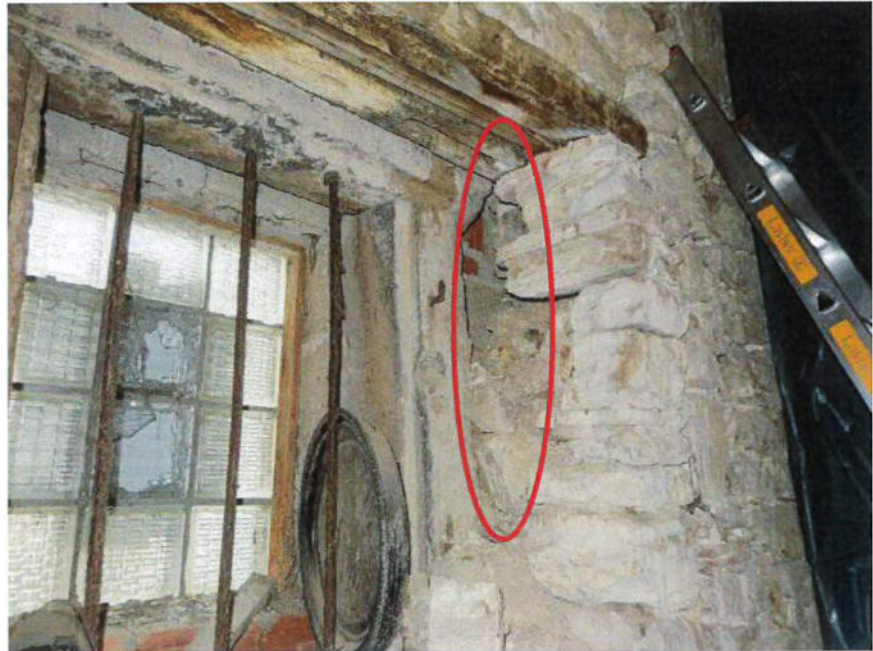
Foto 13: Zwischen dem Mauerwerk aus Bruchsteinen und der dahinter befindlichen Mauer aus Ziegelsteinen befindlicher Spalt
