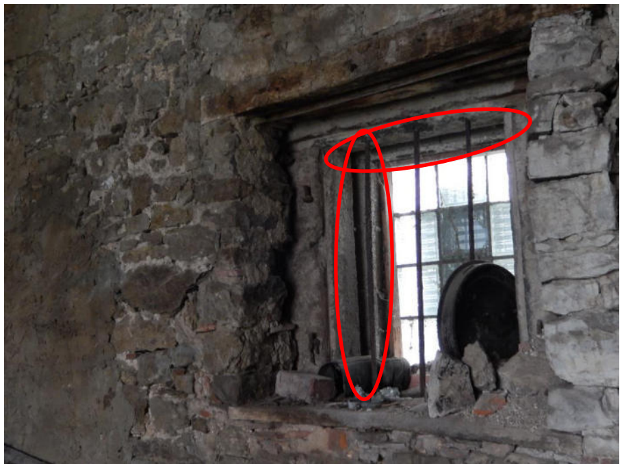
Foto 12: Spalt zwischen den Mauerwerken an der Nordwand des Gebäu- des
