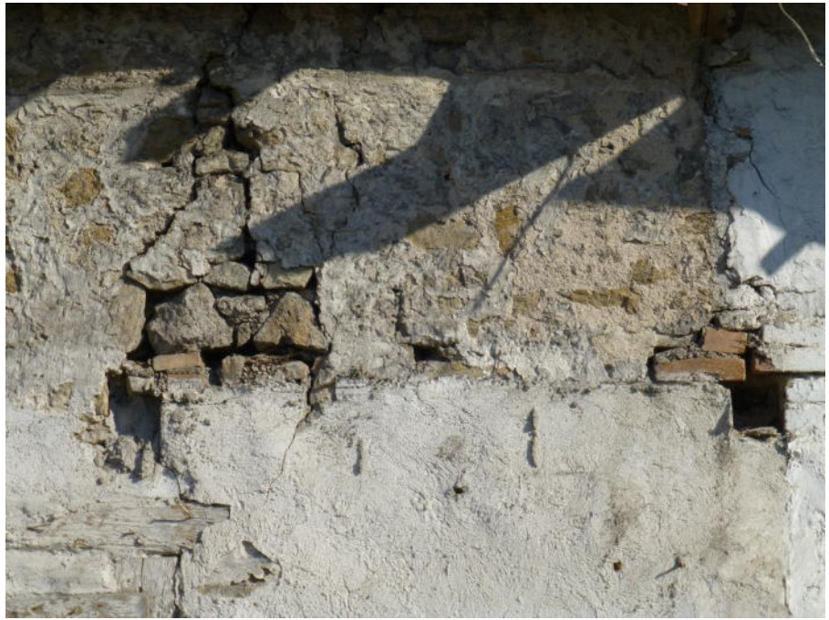
Foto 11: Oberirdische Mauer- spalten stellen z. T ebenfalls potentielle Winterquartierstrukt- uren dar
